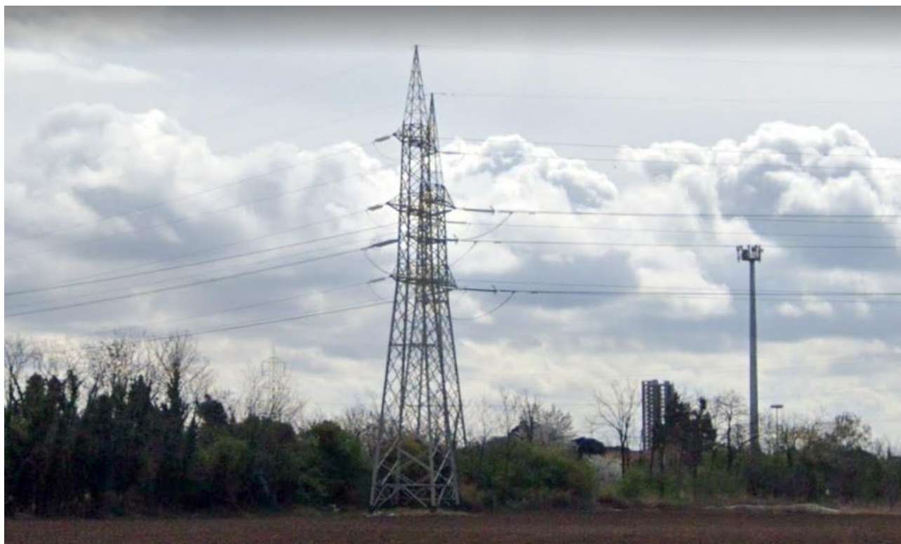
Linea elettrica a 220 kV a sud del territorio comunale.
